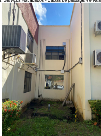
Foto 03: Serviço inacabado - Valas escavadas
