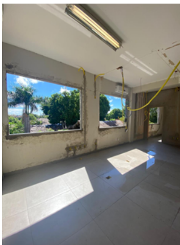
Foto 23: Serviços inacabados - Instalações elétricas, lógicas, esquadrias e execução de revestimento não finalizadas.
