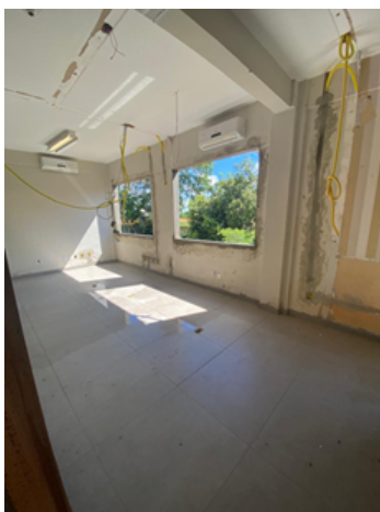
Foto 21: Serviços inacabados - Instalações elétricas, lógicas, esquadrias e execução de revestimento não finalizadas.
