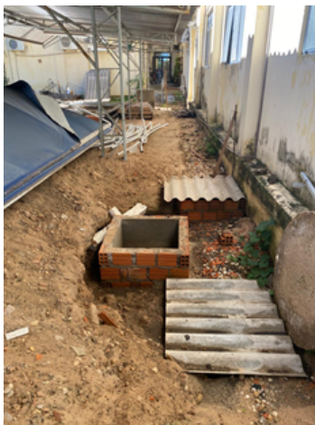
Foto 14: Serviços inacabados - Caixas de passagem não finalizadas.
