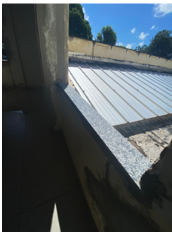
Foto 26: Serviços inacabados - Instalação de esquadrias e execução de revestimento não finalizadas.
