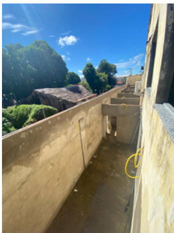
Foto 24: Serviços inacabados - Instalações elétricas, lógicas, esquadrias, cobertura e execução de revestimento não finalizadas.
