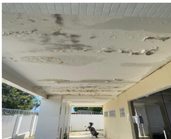
Foto 02: Patologias oriundas de infiltrações na cobertura.
