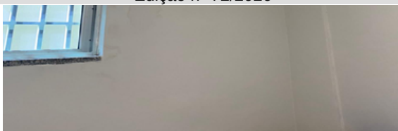
Foto 03: Patologias oriundas de infiltrações na cobertura.
