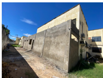
Foto 15: Serviços inacabados - Ampliação do Fórum não finalizada.
