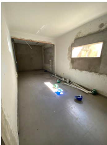
Foto 08: Serviços inacabados - Instalações elétricas, lógicas, esquadrias e revestimento não executados.
