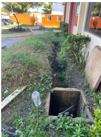
Foto 02: Serviços inacabados - Caixas de passagem e vala abertas
