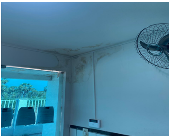
Foto 04: Patologias oriundas de infiltrações na cobertura.
