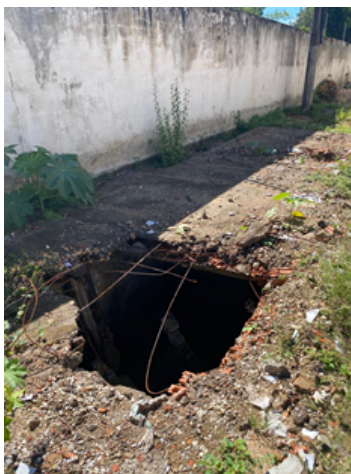
Foto 13: Serviços inacabados - Fossa séptica exposta.
