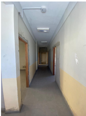
Foto 18: Serviços inacabados - Instalação de esquadrias e execução de revestimento não finalizadas.
