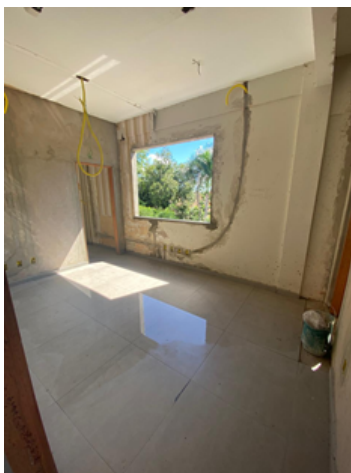
Foto 20: Serviços inacabados - Instalações elétricas, lógicas, esquadrias e execução de revestimento não finalizadas.
