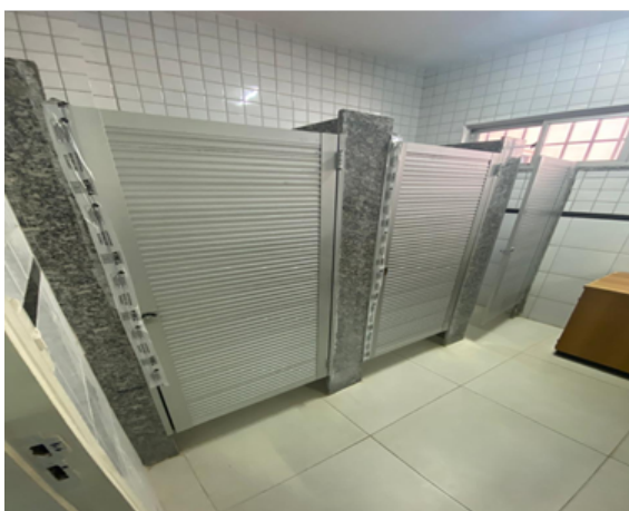
Foto 05: Isolamento devido a falha do abastecimento que impede o fluxo regular de água nos aparelhos sanitários.
