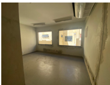
Foto 22: Serviços inacabados - Instalações elétricas, lógicas, esquadrias e execução de revestimento não finalizadas.
