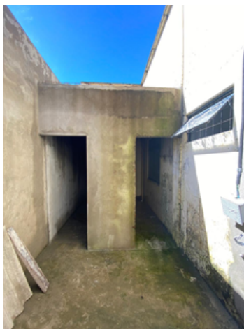
Foto 16: Serviços inacabados - Ampliação do Fórum não finalizada.
