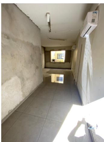
Foto 09: Serviços inacabados - Instalações elétricas, lógicas, esquadrias e revestimento não executados..
