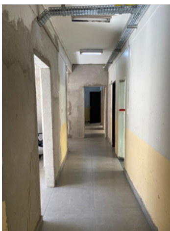
Foto 05: Serviços inacabados - Instalação de esquadrias e revestimento nas paredes não executados
