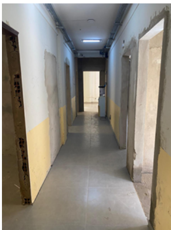
Foto 06: Serviços inacabados - Instalação de esquadrias e revestimento nas paredes não executados.
