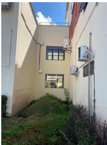
Foto 01: Serviços de capina não executados.
