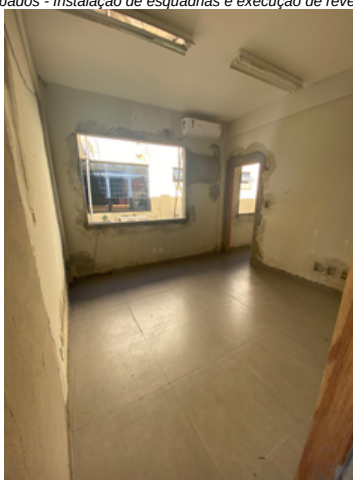
Foto 19: Serviços inacabados - Instalação de esquadrias e execução de revestimento não finalizadas.
