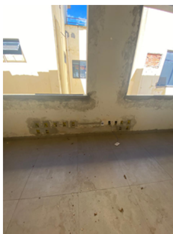
Foto 25: Serviços inacabados - Instalações elétricas, lógicas, esquadrias e execução de revestimento não finalizadas.
